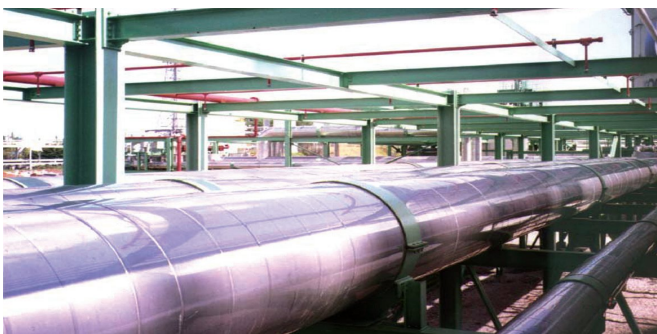
LNG Terminal Pipe Insulation
